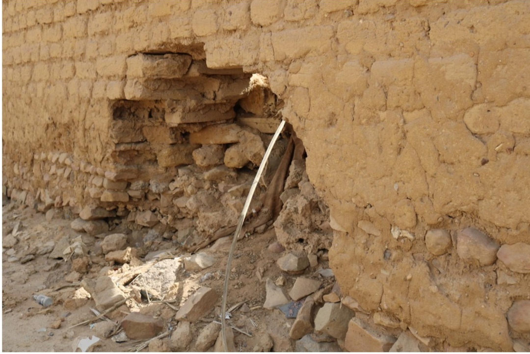
لوحة (٢٥) كسر في الجدار الخارجي ومواد البناء. (تصوير الباحثة بتاريخ ١٥-١٦/٩/٢٠٢٣ م). ١
